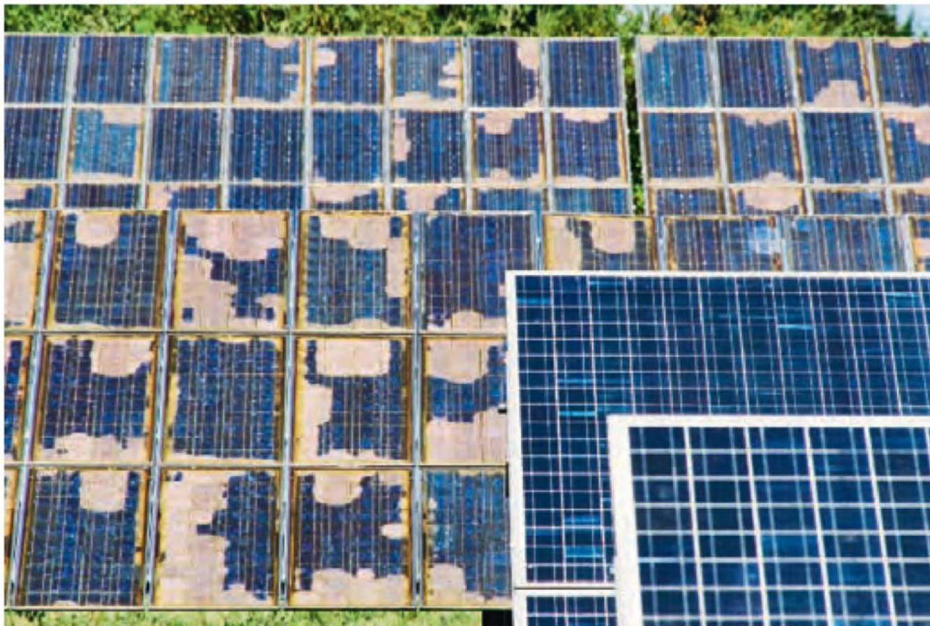
Schlapp gemacht: In der 1988 errichteten 340-Kilowatt-Anlage im Moseltal bei Kobern ist der Leistungsverlust nicht zu übersehen. Die von RWE betriebene Anlage, einstmals Europas größte, ist eine der wenigen mit einer solchen Langzeiterfahrung.
